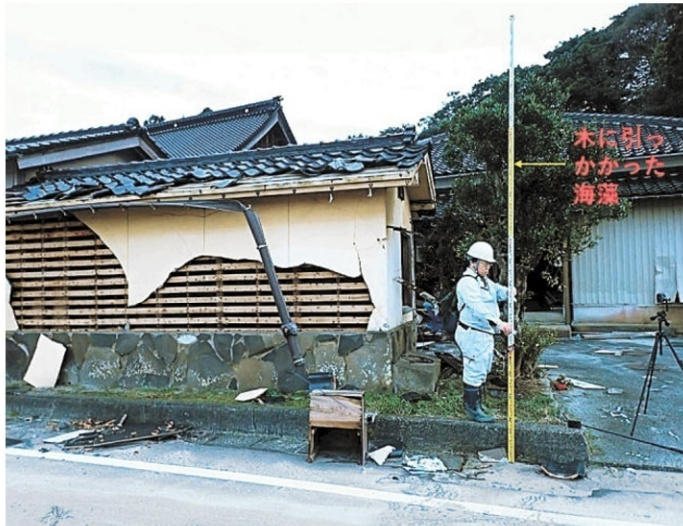
木に付着していた海藻の高さを測る静岡大の原田賢治准教授。すぐ左の屋根瓦もほぼ同じ高さまで流失している ＝22日、石川県能登町（北村晃寿教授提供）
