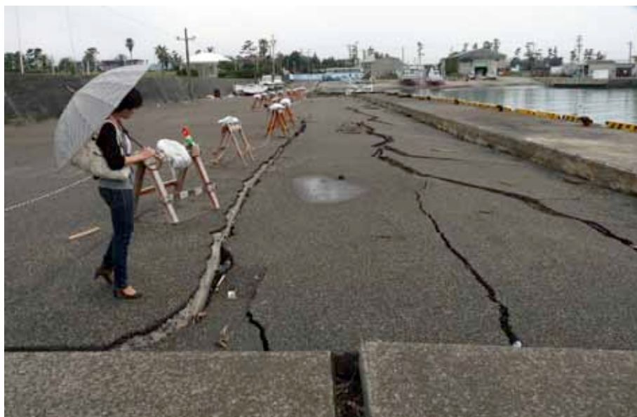
写真 3-3 2009年8月11日の駿河湾の地震による相良港の突堤の被害。
